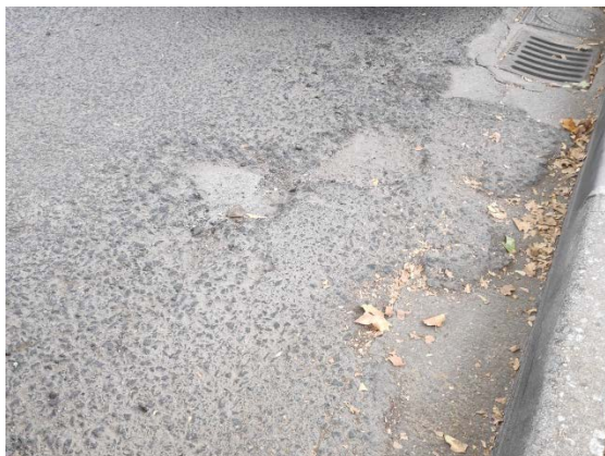
Foto 18: Imbornal + zona descarnada
