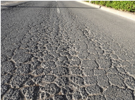
Foto 5: Agotamiento estructural. Piel de cocodrilo
