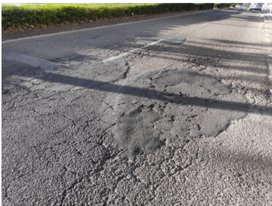
Foto 7: Fisuras en repeticiones de firme
