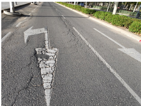
Foto 19: Señalización horizontal deteriorada
