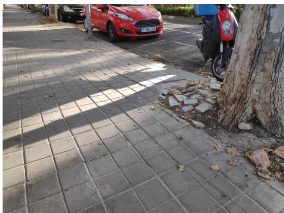
Foto 11: Baldosas levantadas por crecimiento raíces
