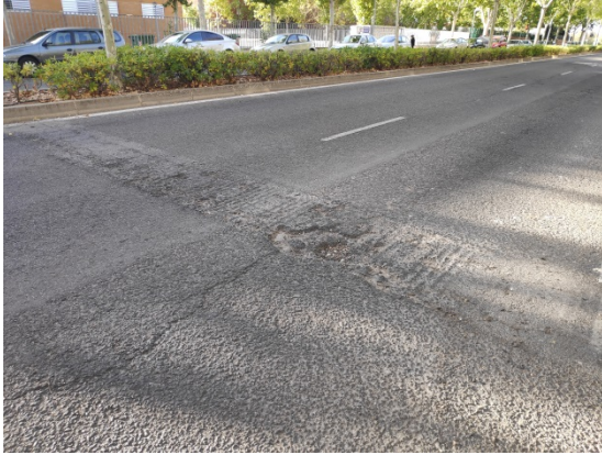
Foto 3: Firme disgregado. Tramo 1 entre glorietas
