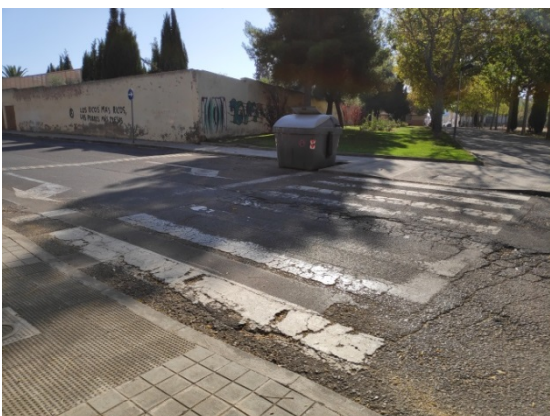
Foto 22: Firme fisurado en paso peatones.
