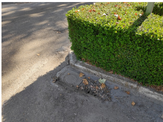
Foto 17: Imbornal obstruido en intersección
