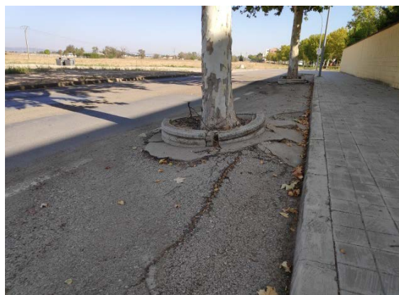
Foto 8: Pavimento levantado en cordón aparcamiento
