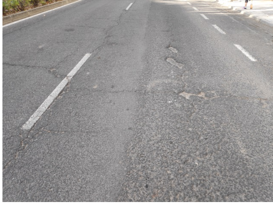
Foto 4: Firme disgregado. Tramo 1 entre glorietas
