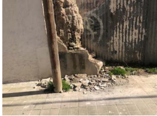
Foto 4. Desprendimientos en las aceras
