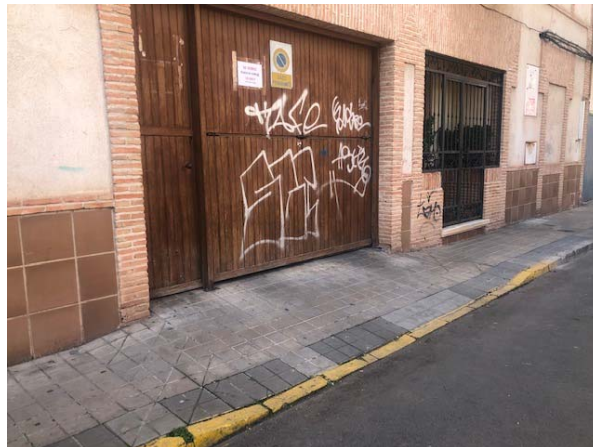
Foto 11. Accesos a garajes con demasiada pendiente transversal.
