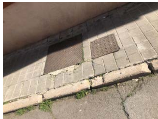
Foto 2. Bordillos y acerados en mal estado
