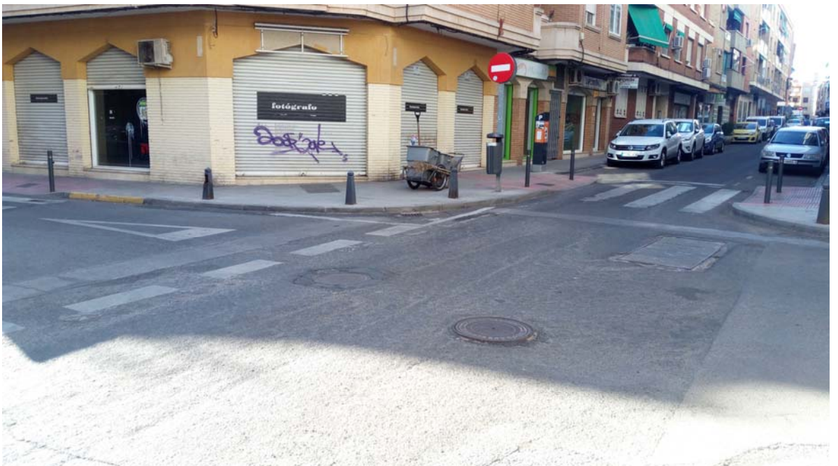
Encuentro con la calle Quevedo. Firme en mal estado. Deterioro de pozos y arquetas existentes en el pavimento.
