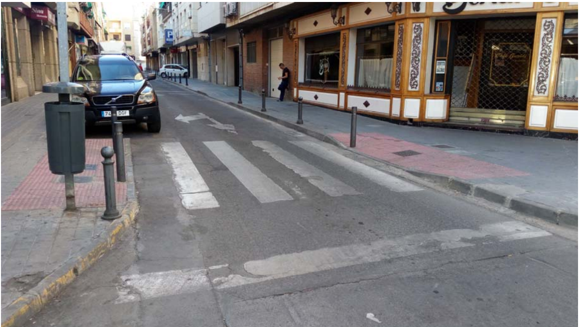
Pavimento en mal estado. Ausencia de algunos bolardos y diferentes tipologías.
