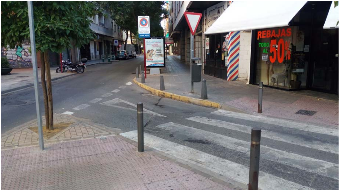
Encuentro con la calle Calatrava. Firme en mal estado. Pendiente excesiva en el paso de peatones existente.
