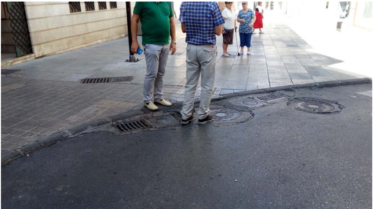
Acumulación de sumideros, pozos y arquetas rehundidos.
