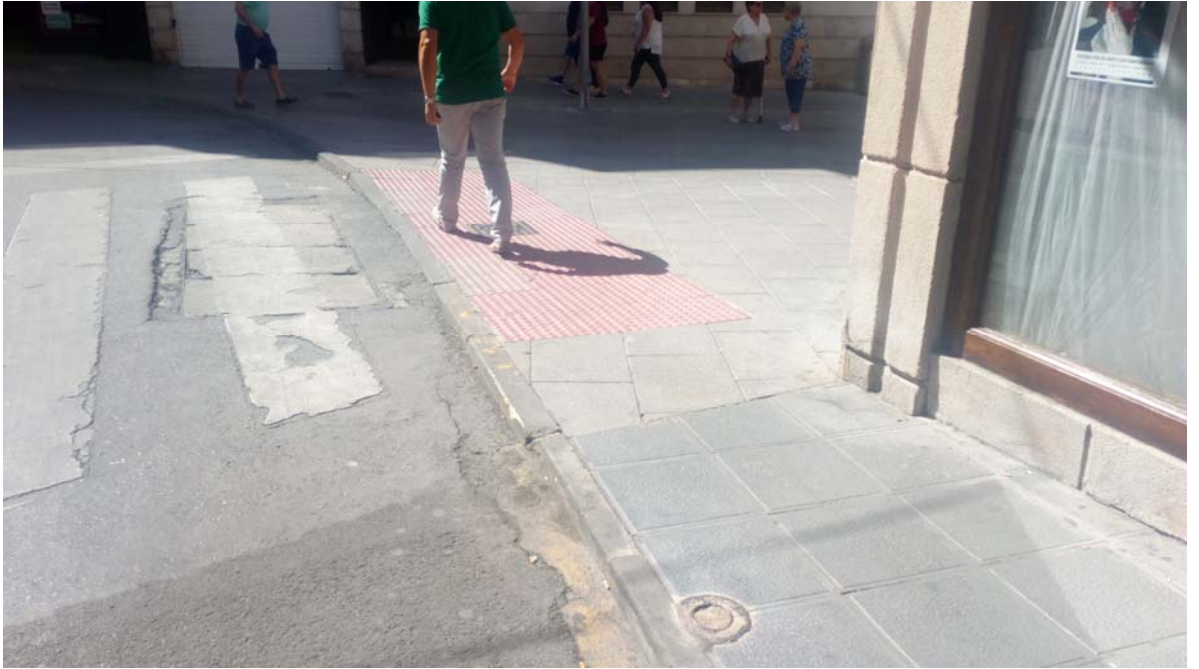
Encuentro con la calle Lanza. Firme en mal estado, por zanjas y arquetas hundidas y bolardos de acerado eliminados.
