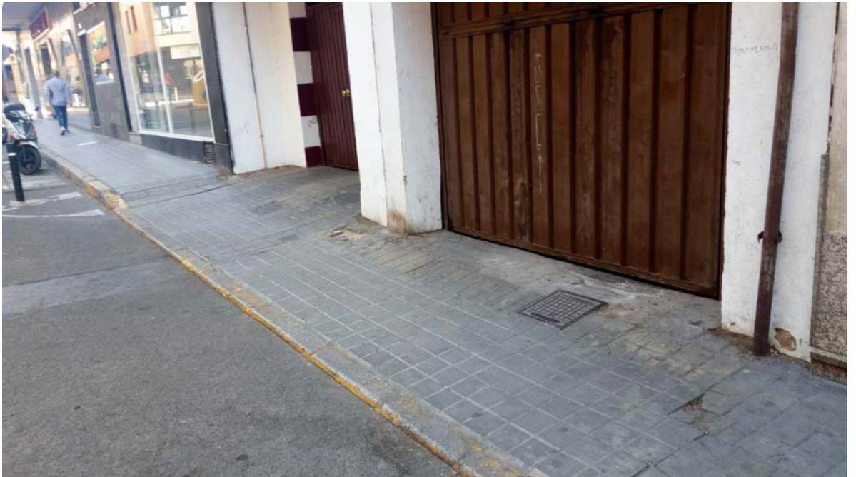
Pavimento de las aceras muy deteriorado. Pendiente transversal excesiva en garajes.
